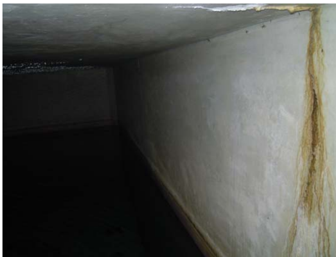
Foto 7: infiltrazioni dal tetto
